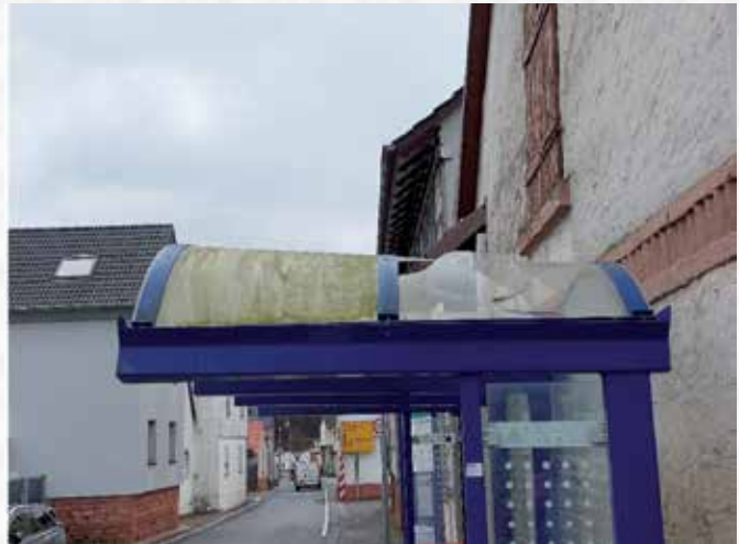
Beschädigte Bushaltestelle Radheim
